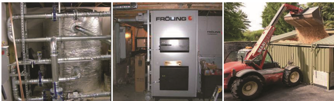
写真 4.7.4 内部の配管と緩衝槽(左)、Froling 500kW Turbomat ボイラー(中)、地上部に建設された燃料貯蔵庫に投入されるチップ(右)
