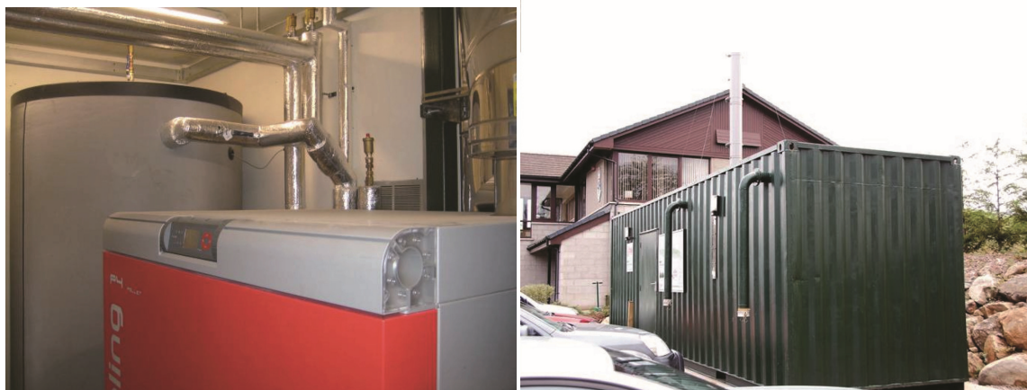
写真 4.7.2 バイオマスボイラ(左)、(右)
